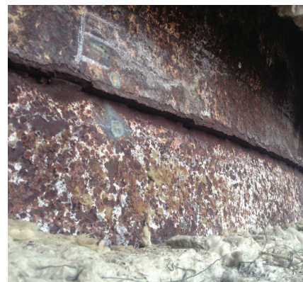
Grieta circunferencial en faldón
