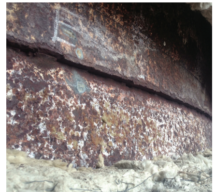
Umlaufende Risse an der Standzarge
