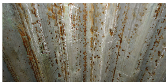
Rohrwand nach Kupfersulfattest
