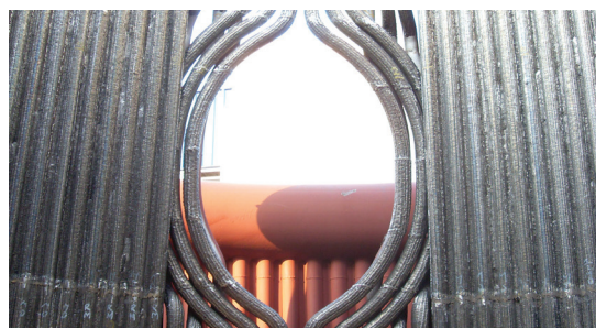
360° geschweißte Rohre mit Ausbiegungen
