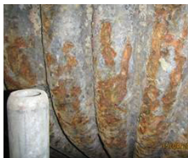
Rauchgasseitige Korrosion in einem kohlebefeuerter Kessel
