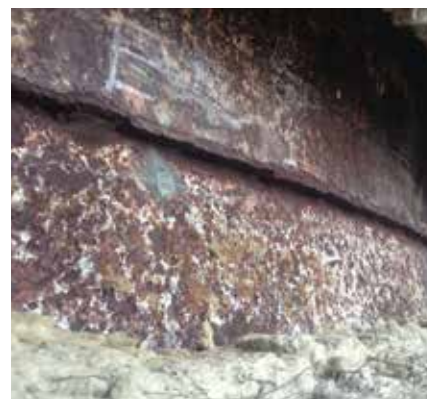
Fissures sur tout le pourtour de la jupe
