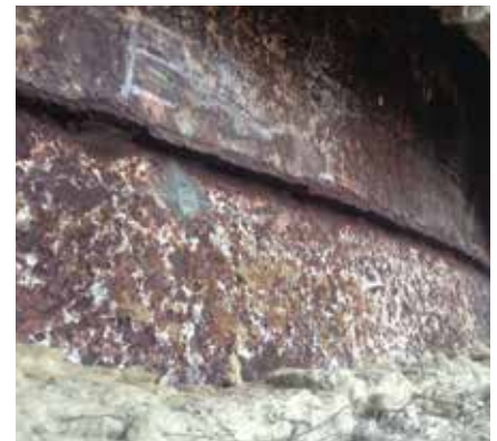
Umlaufende Risse an der Standzarge
