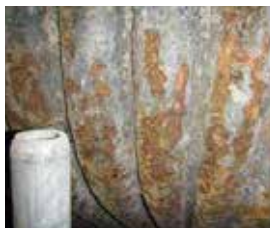
Rauchgasseitige Korrosion in einem kohlebefeuerter Kessel
