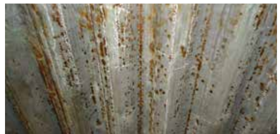
Rohrwand nach Kupfersulfattest
