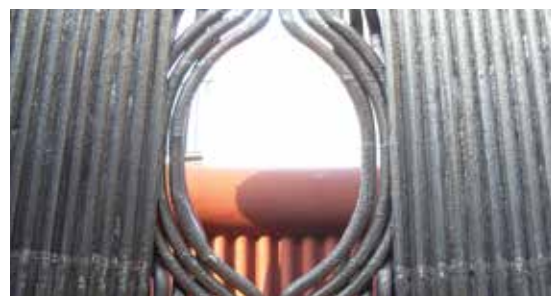
360° geschweißte Rohre mit Ausbiegungen
